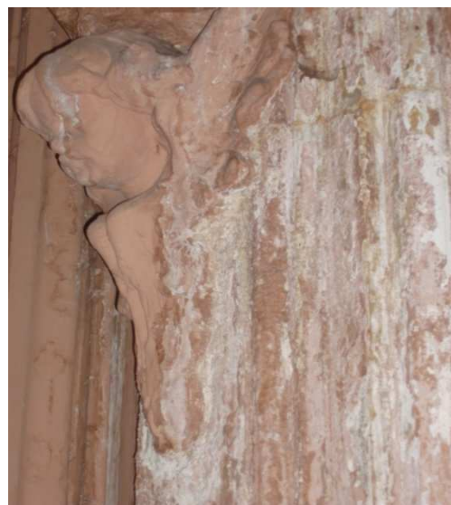
Рис. 4 Ділянка 6. Стіна під хорами.
