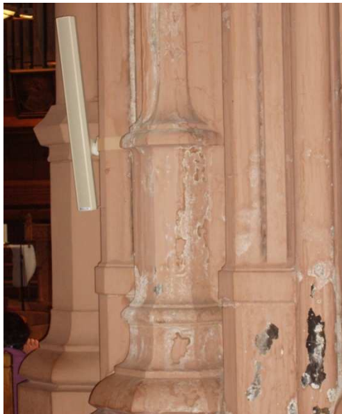
Рис. 1 Ділянка 1. Покриття правої колони нефу.
