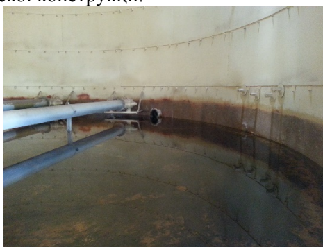
Рис. 1. Мікробіологічне корозійне ушкодження вертикального резервуару зберігання авіаційного палива на підприємстві авіаційного паливозабезпечення. Фото: О. Матвєєва
