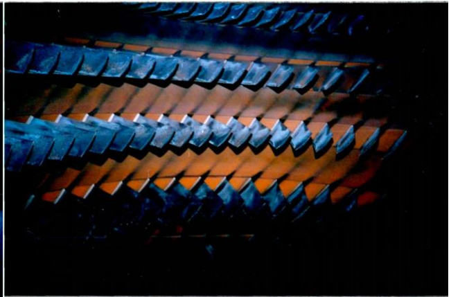
Рис. 5. Забруднення лопаток НА-4, НА-5, НА-6 і НА-7 у верхній половині статора
