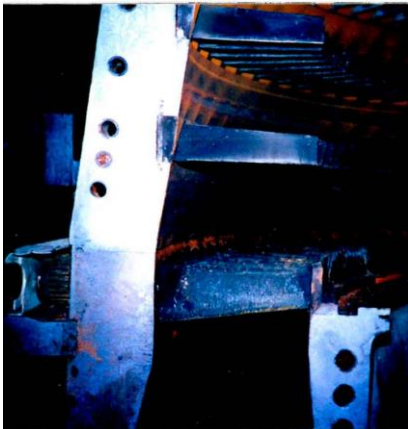
Рис. 4. Забруднення лопаток ВНА, НА-1 На-2 у верхній половині статора
