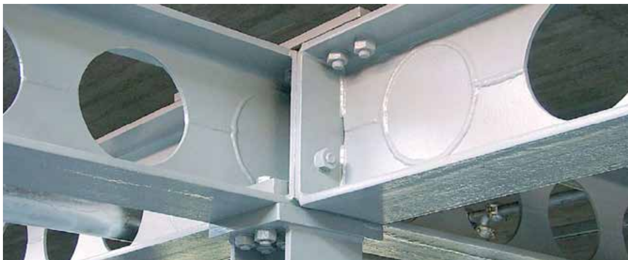
Рис. 4. Приклад завареного отвору біля опори на реальному об'єкті
