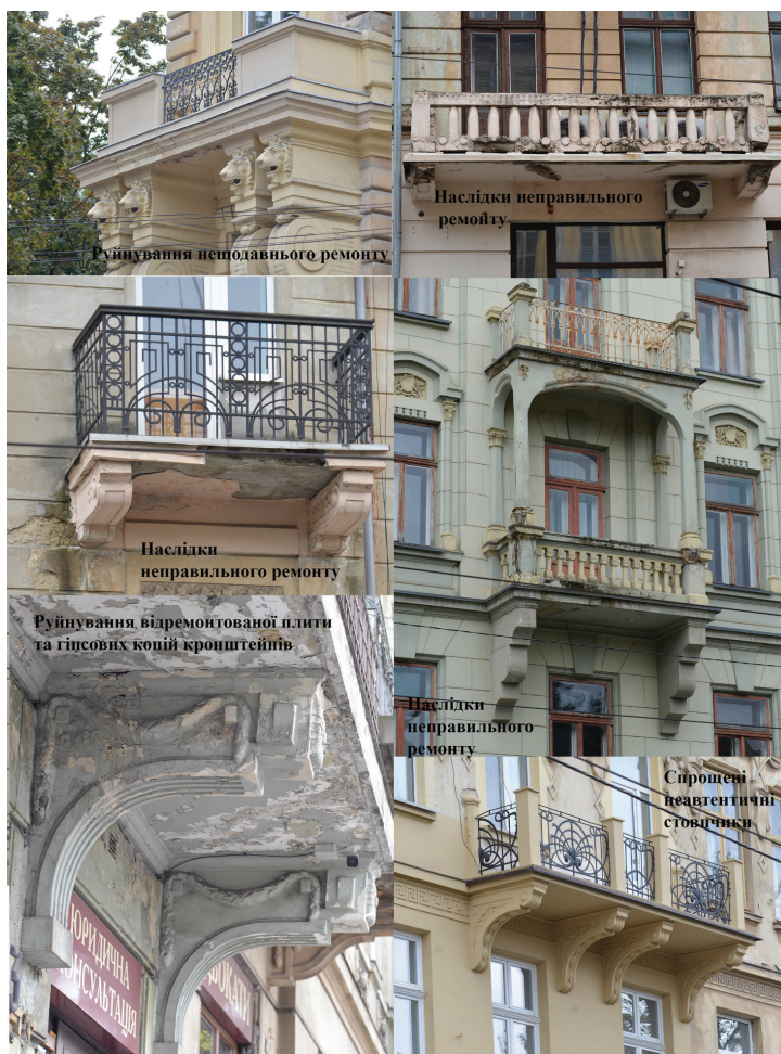
Рис. 3. Руйнування балконів після ремонтів
