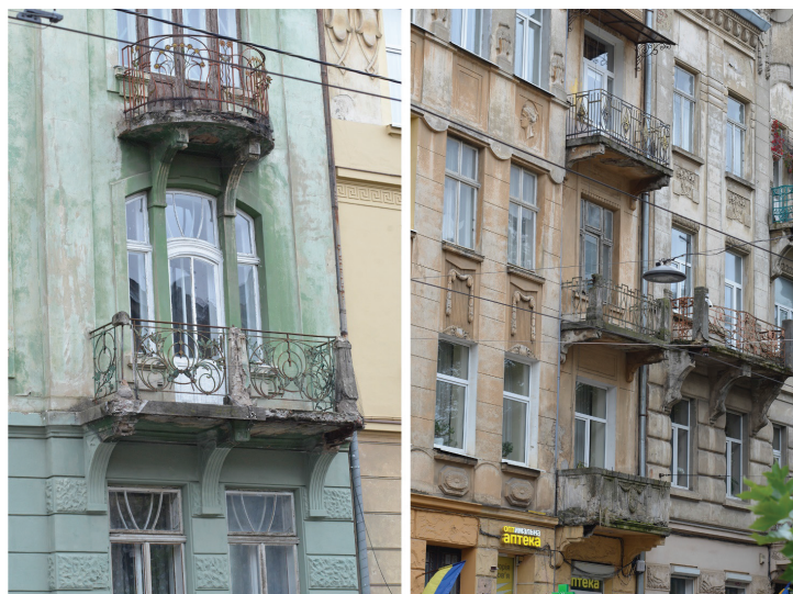
Рис. 2. Комбінація різних типів огорожень на фасаді. На балконах помітні руйнування стовпців, кронштейнів, балконних плит, біоураження поверхонь
